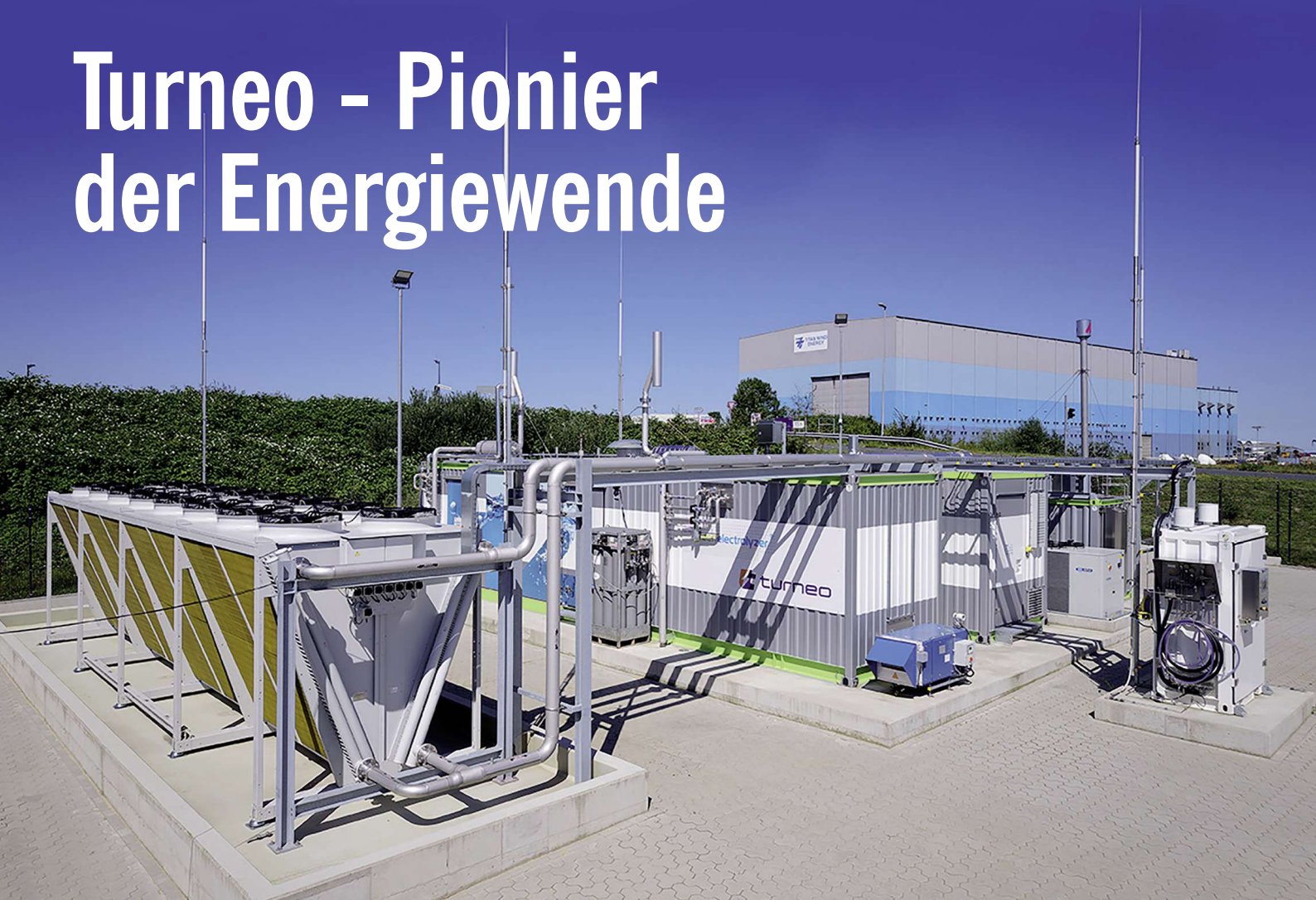
Elektrolyseanlage in Cuxhaven mit einer Leistung von 2 Megawatt zur Erzeugung „grünen“ Wasserstoffs, ausbaufähig bis auf 50 Megawatt. Foto: Turneo
