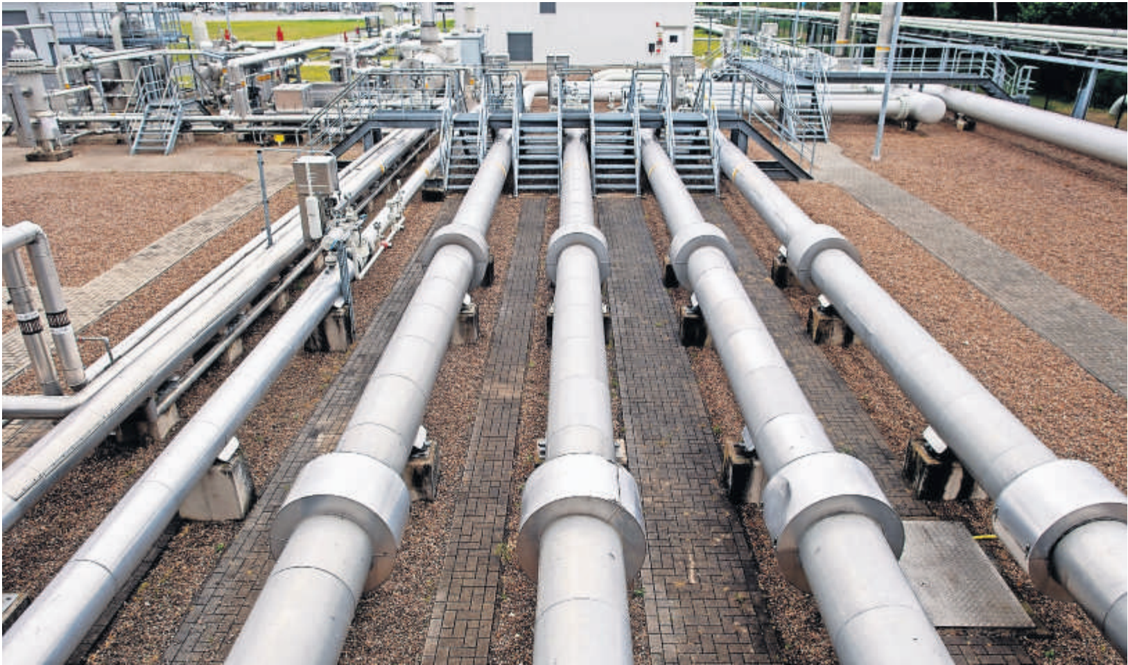
Zahlreiche Rohre verlaufen an einer technischen Anlage zur Verdichtung von Erdgas auf dem Gelände des Erdgasspeichers Rehden der SEFE Storage GmbH. Foto: Dittrich/dpa
