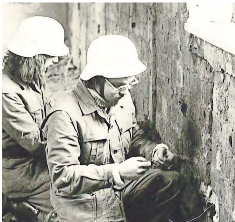
Letzte Vorbereitungen kurz vor der Sprengung des Bunkers am Seedeich durch das THW.
