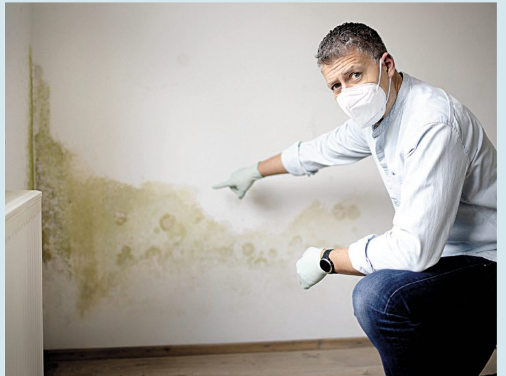
Außenwände sind besonders gefährdet für Schimmelbildung. Fotos: spp-o
