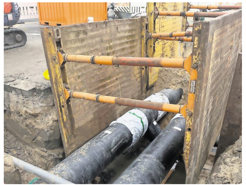
Die Fernwärme-Rohrleitungen von Forte Energie sind mit der höchsten Dämmstärke ausgestattet. So bleibt die Temperatur über die Transportstrecke bestmöglich geschützt.
